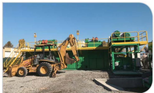
Sistema de tratamiento de lodos Hydrovac
